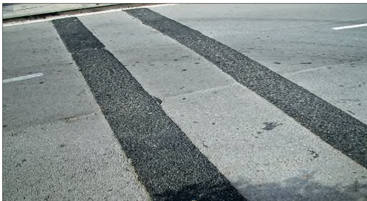
Bandes rugoses a una carretera de la nostra comarca
