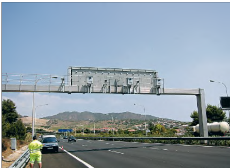
Radars instal·lats en una autopista catalana
